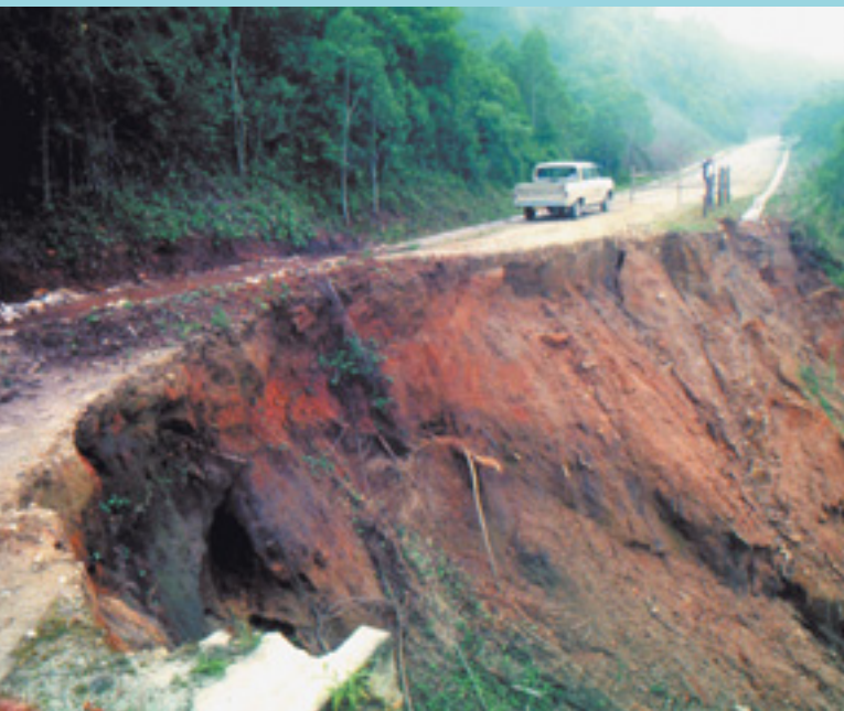
Deslizamento de terra na estrada de acesso ao Observatório Astrofísico Brasileiro, 1983 FONTE: ARQUIVO HISTÓRICO DO LNA
