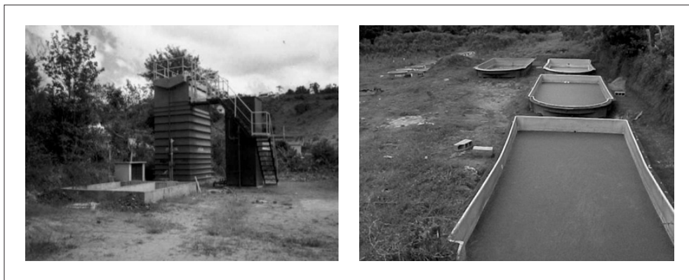
Figura 8.6 Vista do conjunto UASB+ BF+ série de lagoas de polimento/tanques de piscicultura, Unidade Integrada de Tratamento e Utilização de Esgotos da Violeira, Viçosa-MG
