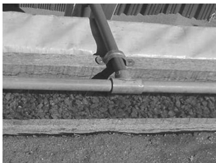
Figura 7.11 Caixa de brita para a distribuição do esgoto
