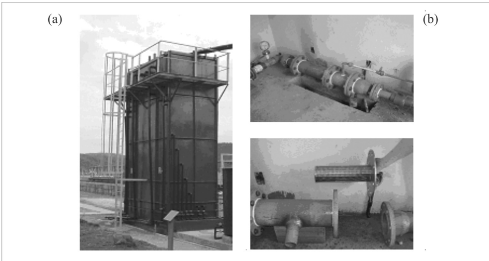
Figura 3.14 Vista dos reatores UASB (a) e da unidade de peneiramento forçado (b) da UFMG
