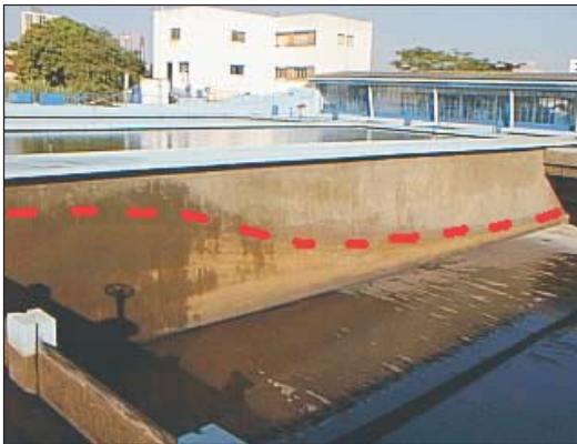
Perfil de lodo indicado ao longo de um decantador convencional de escoamento horizontal após limpeza manual
