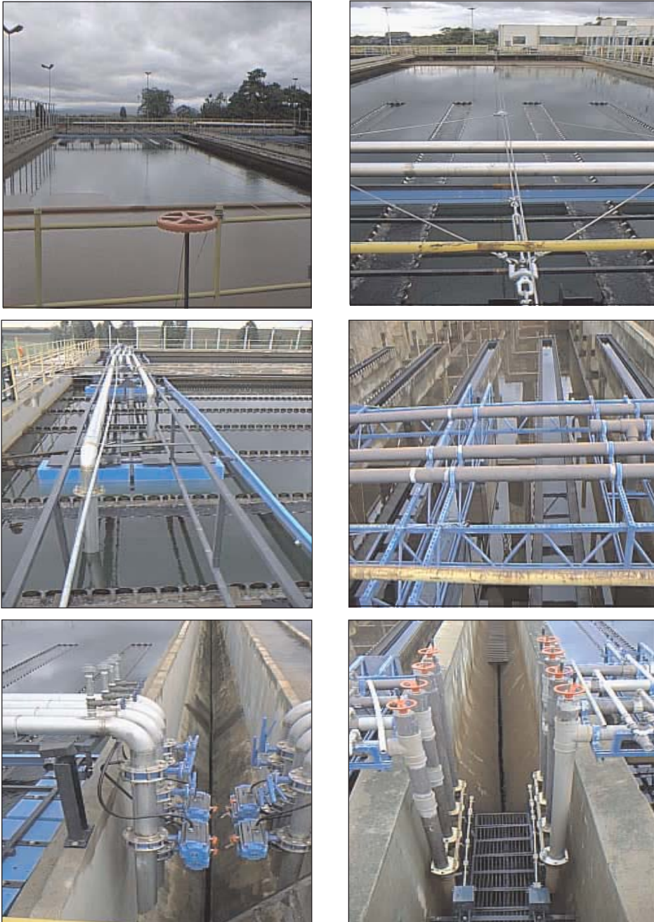
Figura 8.2 Fotos ilustrando equipamento de sifão flutuante móvel para remoção de lodo de decantador convencional.
