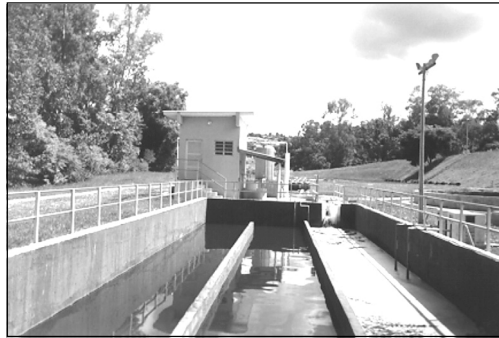
Figura 4.13 Tanque de contato com regime de escoamento de fluxo pistão (ETE Caçadores, Cambé, PR).
