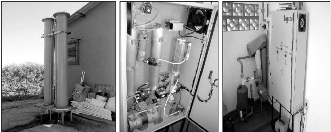
Figura 5.17 Vistas da coluna de ozonização e do gerador de ozônio.
