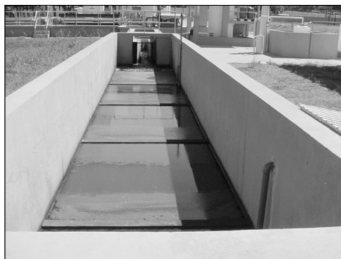
Figura 4.12 Tanque de contato com chicanas (ETE Cambuí, Campo Largo, PR).
