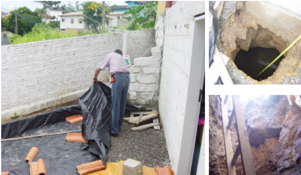
Figura 7 – Buraco surgido no pátio de uma residência no bairro Maria Céu em Criciúma/SC, revelando uma área minerada em subsolo
