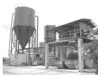
Figura 9: ETE (Tratamento Efluente)
