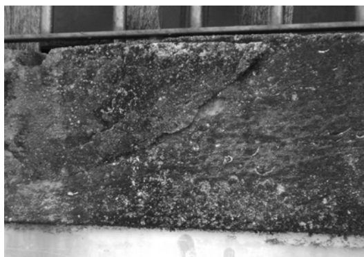
Figura 10** - Esfoliação e pitting , cercadura de janela; Igreja de Nossa Senhora da Piedade – Jaboatão dos Guararapes/PE.
