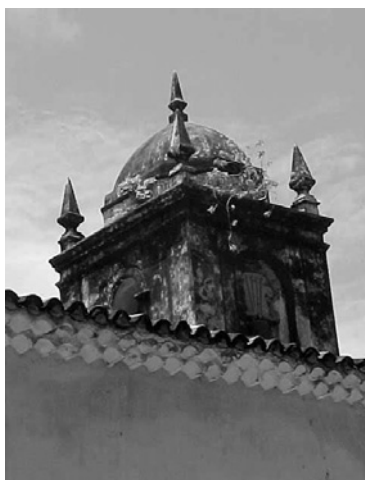
Figura 12* - Presença de vegetação e crosta negra, torre sineira; Igreja de Nossa Senhora das Neves/Conv. Franciscano – Olinda/PE.
