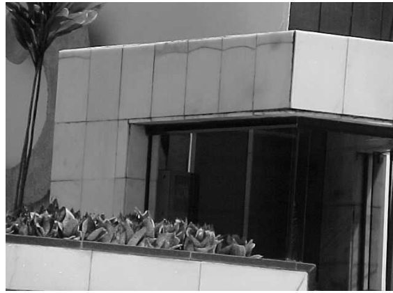
Figura 5: Fissuras (Mármore Branco) Fonte: Silva, S.A.
