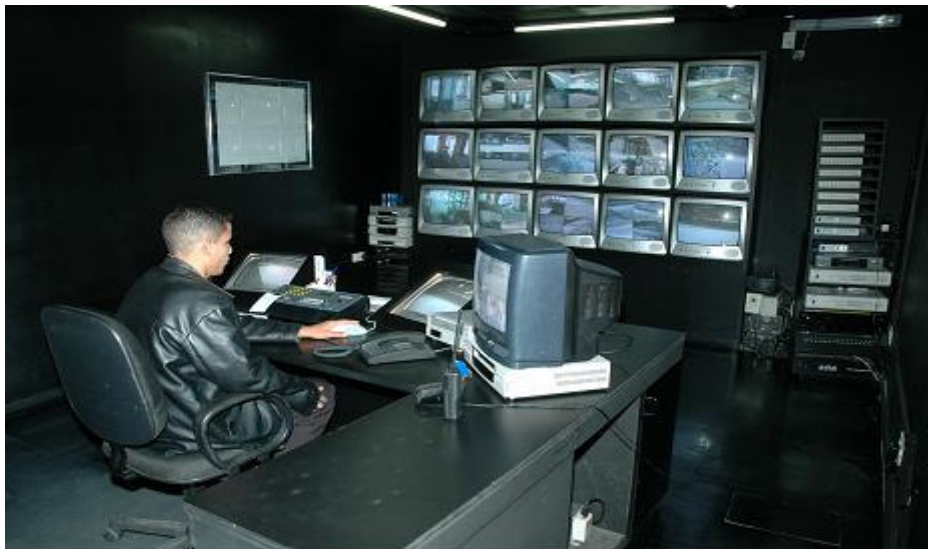
Figura 5.3-28: Controlador de Terminal
