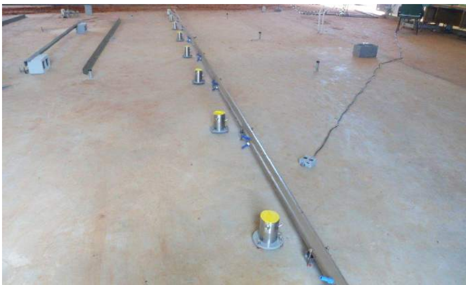
Instalação de sensores de nível micrométricos para investigação de deformações em piso-protótipo
