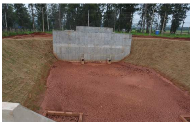
Tanque de retardo provisório de águas pluviais
