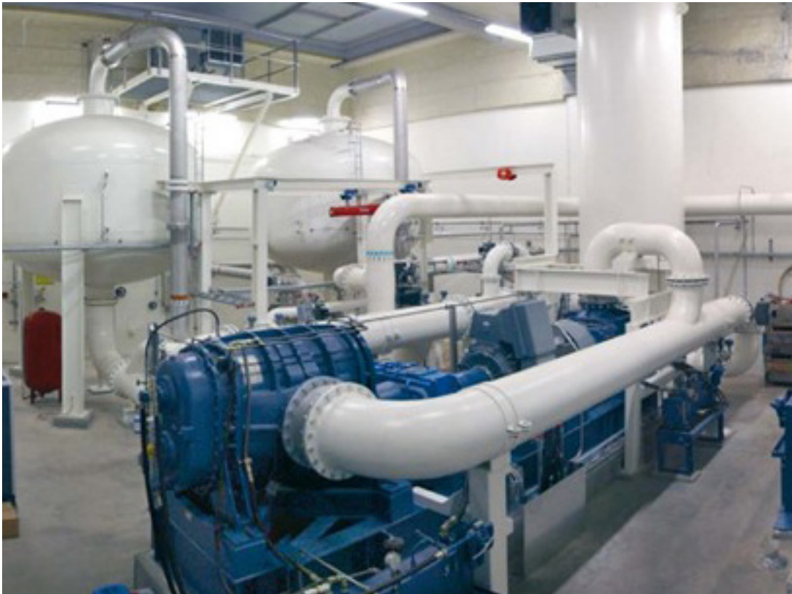
Figura 14 – Unidade VPSA para 1.300 Nm 3 /h de Oxigênio
