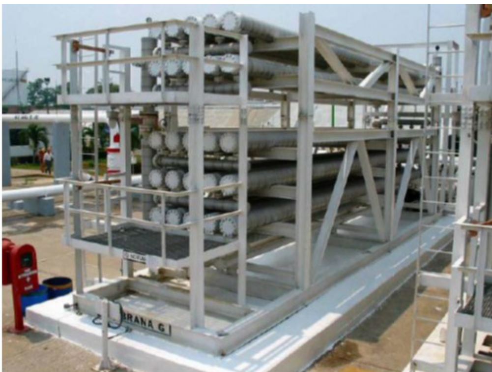
Figura 36 – Skid com Módulos de Membrana do Tipo UOP Separex™
